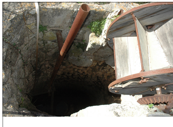
Descripción: Muro del pozo, tubo que conecta con 229.2 y rueda con palas.
