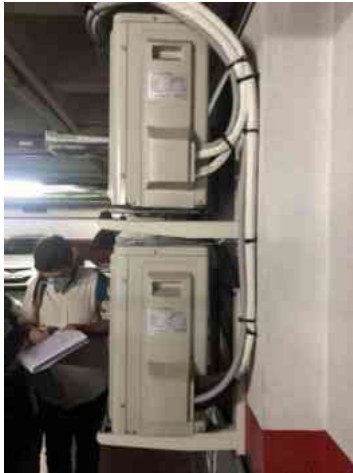
Fotos d'instal·lacions de clima:
