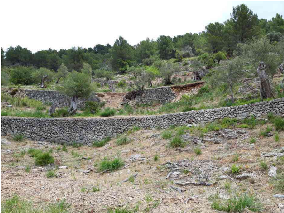
Detall de l'estat dels trams per reconstruir
