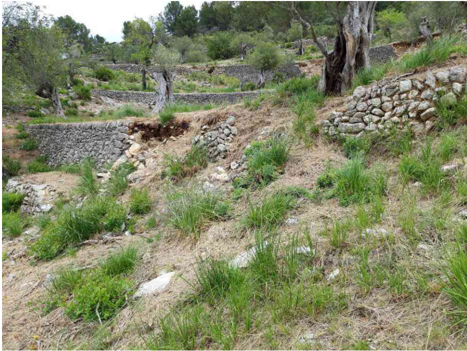
Detall de l'estat dels trams per reconstruir
